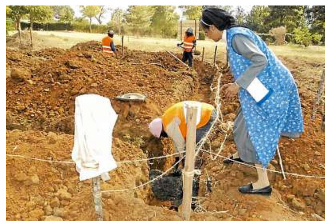
Die Schwestern, die in der Schule arbeiten, packten beim Fundamente gießen mit an.
